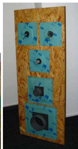
Cevi morajo biti prilepljene na zrakotesno ravnino, da ne predstavljajo netesnih mest.
